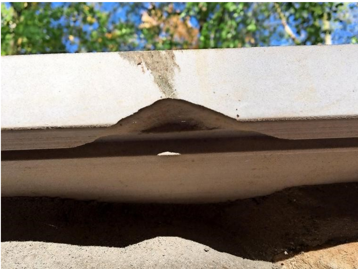
Eine der neuen Sandsteinplatten ist beschädigt. Quelle: privat
